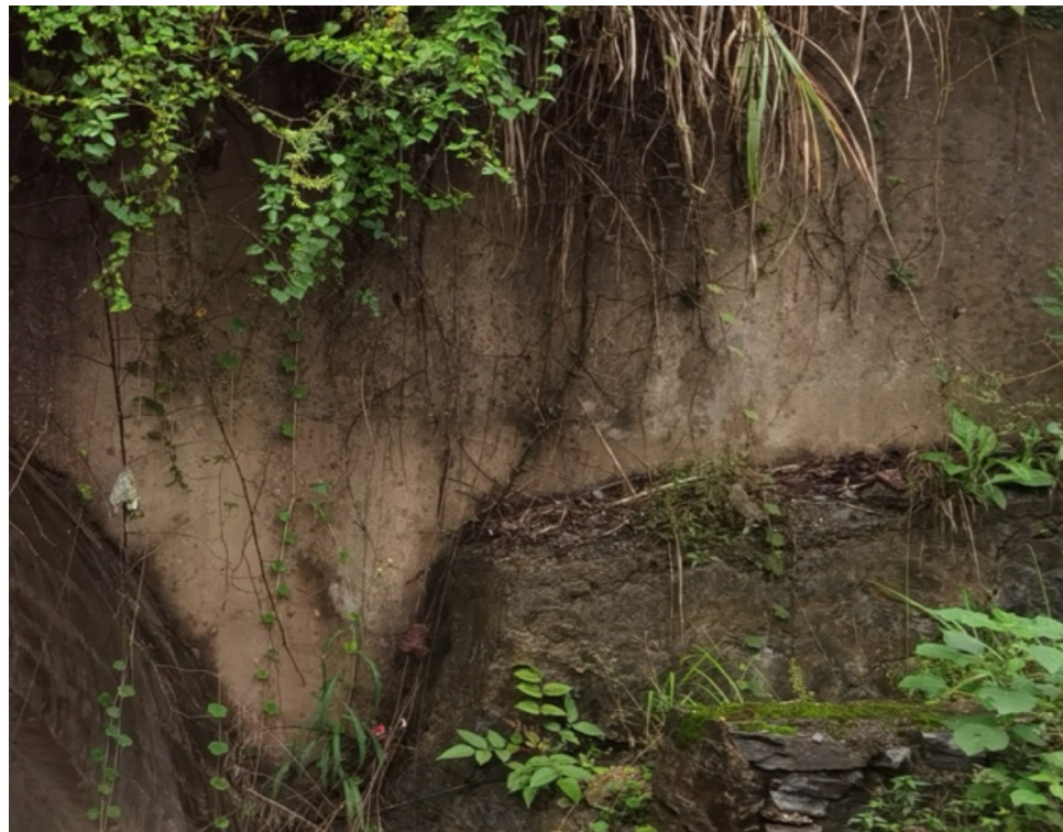
3、主拱圈与上游侧拱上结构脱裂，已长出杂草
