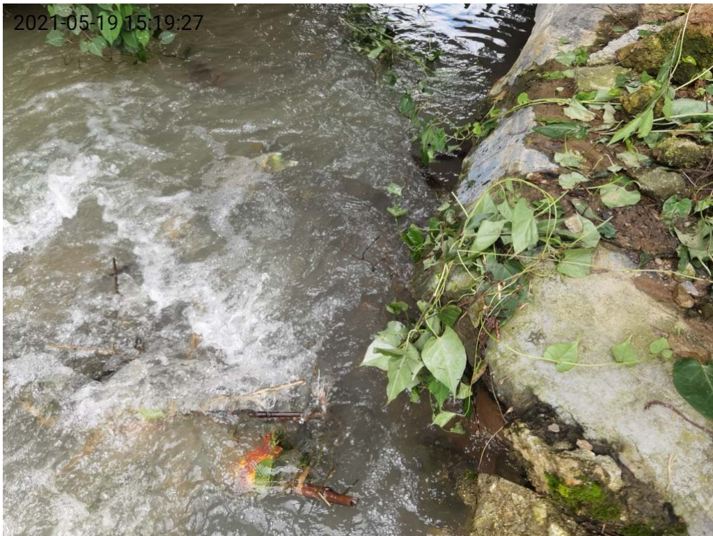
3、1 号桥台基础冲空
