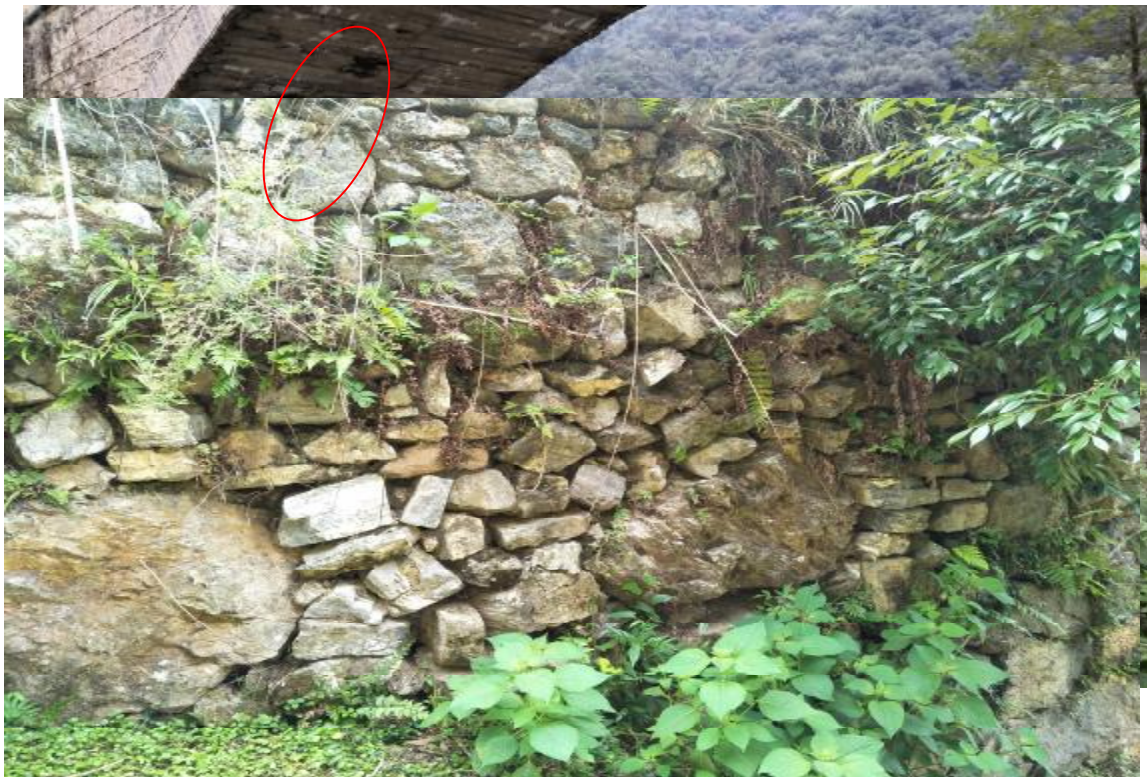
图 1-3 砂浆脱落、渗水泛碱
