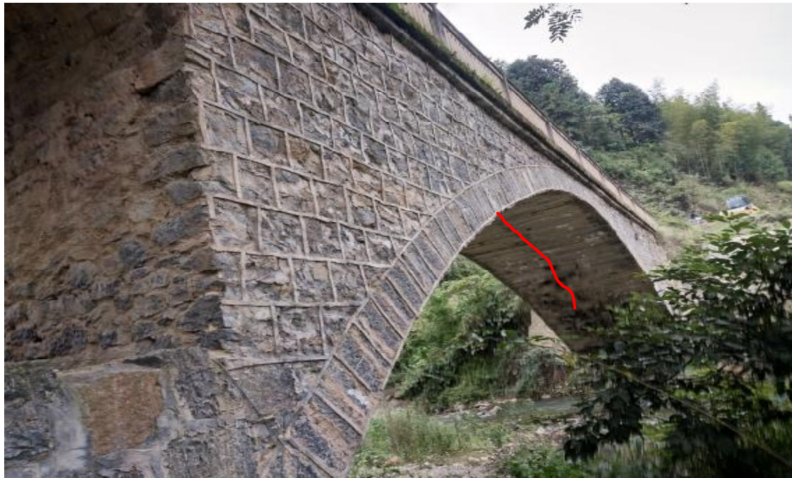
图 1-2 主拱圈出现纵向裂缝
