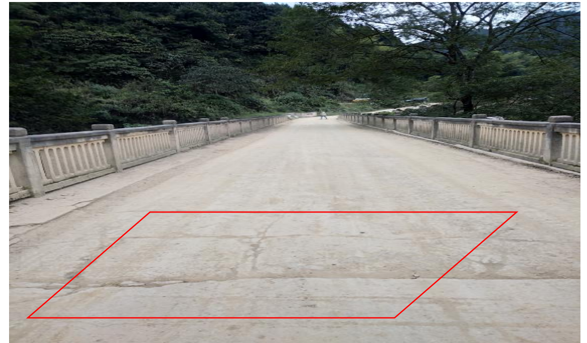
图 1-5 桥面铺装裂缝，破损
